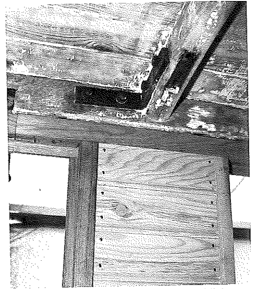
Probleme gab es mit der original gebliebenen Decke: Wochen nach Entfärbung des Daches mußten mehrfach ausgetretene Salzkristalle entfernt werden, bevor mit der Lackierung begonnen werden konnte. Foto: Klaus Prömper
