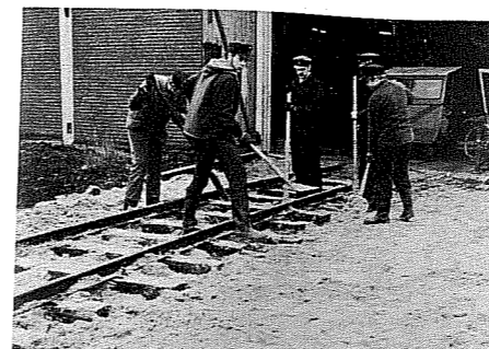
DVE-Rotte beim Bau eines neuen Abstellgleises hinter der Fahrzeughalle. Foto: Jörg Reith
