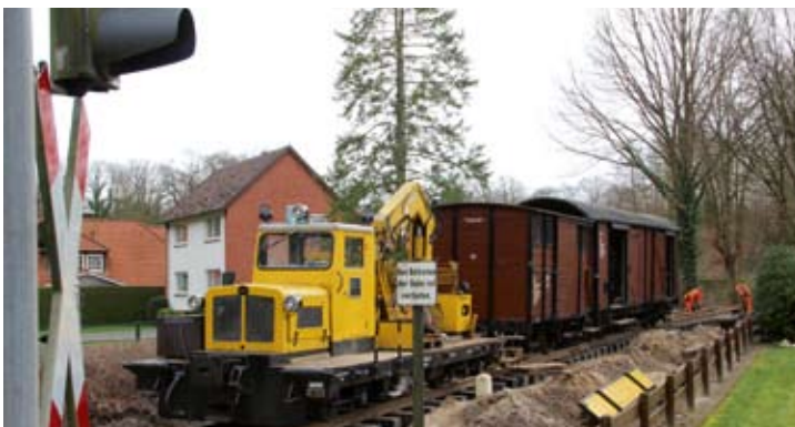
Skl „Friedhelm“ stand mit dem Bauzug am BÜ Homfelder Straße auf dem Baugleis. Vor der Sommersaison begann dann die HU an diesem für die Gleisbaurotte so wichtigen Fahrzeug. 16.03.23
