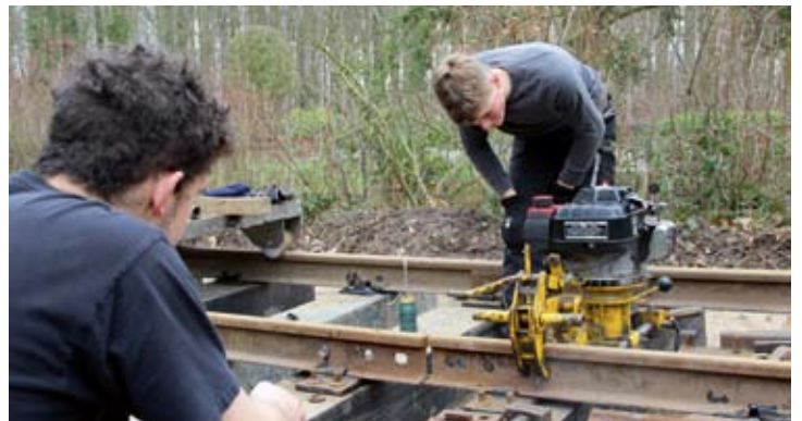
Am Sonnabendmorgen konnten die Schienenstöße verlascht werden. Nils Böcker (vorne) und Hauke Tschigor bohrten dafür die nötigen Löcher mit der Schienensteg-Bohrmaschine. 18.03.23
