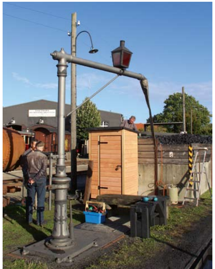
Das neue Traföhäuschen am Kohlebansen ist beinahe fertiggestellt. Das vorherige in Anmutung eines WC-Häuschens war marode geworden. 2. Oktober 2022, alle Fotos: RM
