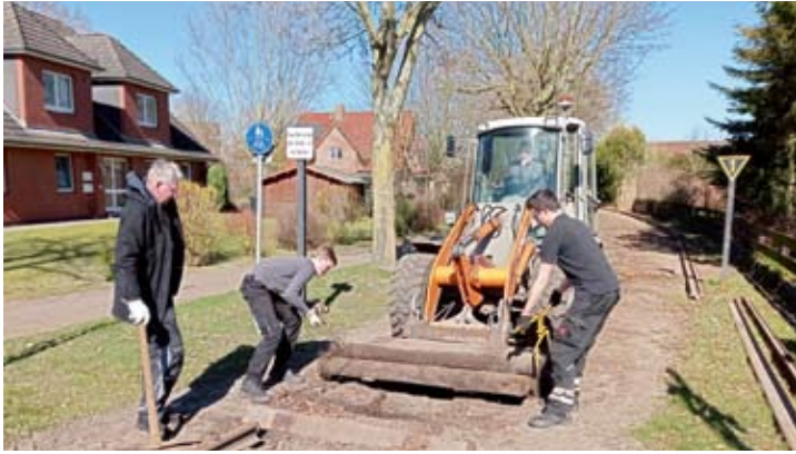
Ab dem 18. März wurden von km 0,35 bis km 0,45 die Schwellen erneuert. Frank, Hauke und Eike verladen am 19. März die letzten Altschwellen auf den Radlader.
