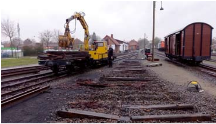
Bei Weiche 15 und Schuppengleis 18 in Bruchhausen-Vilsen wurden ab 15. Februar Bettung und Schwellen erneuert. Die alten Holzschwellen sind reif für die Entsorgung.
