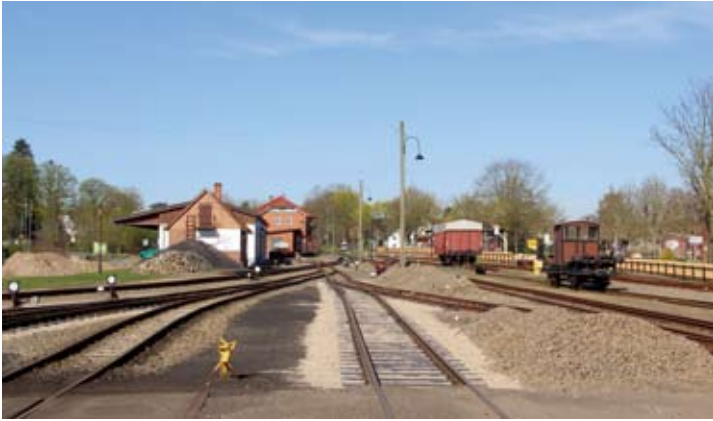
Mit seiner neuen Kiesbettung sieht Gleis 18 rechts jetzt wieder richtig nach Kleinbahn aus. Nur die Schotterberge müssen noch umgelagert werden.
