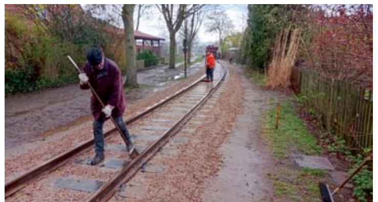
Am 7. April wurde das neue Gleis noch gereinigt. Konrad und Hannes mussten schon wieder im Regen arbeiten. Wenn nicht anders angegeben alle Fotos von Robert Angerhausen
