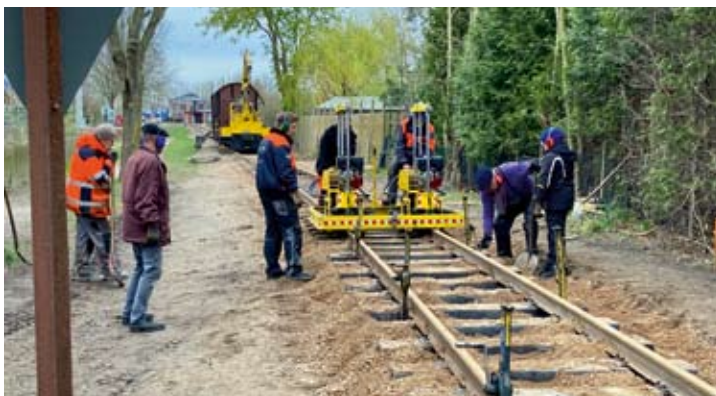
Am 6. April waren Franz und Robert beim Stopfen mit der Stopfmaschine, während die anderen die Winden umsetzten oder Kies schaufelten, wo erforderlich. Foto: Jens Böcker
