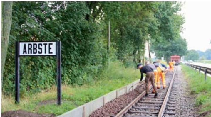
Die Gleisbaurolle hat über den Sommer die Bahnsteigkante in Arbste erneuert und verfüllt nun die letzten Lücken am Gleis mit Schotter. Arbste, 28. August 2021. Foto: RM
