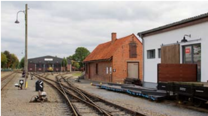
Die neuen Kunststoffschwellen für den weiteren Schwellenwechsel an der Doppelkreuzungsweiche liegen zum Einbau bereit. Bruchhausen-Vilsen, 7. Oktober 2021. Foto: RM
