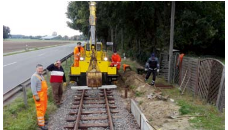
Auch der andere erneuerte Streckenabschnitt am Haltepunkt Arbste nähert sich der Vollendung: Setzen der neuen Bahnsteigkanten am Bahnsteig. 26. September 2020, Foto: Robert Angerhausen
