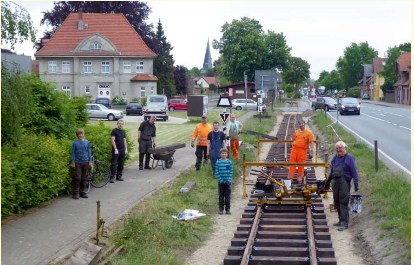
Nach COVID-19-bedingter Baustellenverzögerung konnten die Gleisbauarbeiten in Asendorf im Mai 2020 fortgesetzt und soweit zum Abschluss gebracht werden, dass ab Pfingsten wieder Züge nach Asendorf verkehren konnten. Doch auch in den Wochen danach musste noch die Kiesbettung erstellt und gestopft werden. Am 19. Mai versammelten sich die Aktiven vor der Kamera von Robert Angerhausen (v.l.n.r.): Hauke Tschigor, Max Schwarz, Lars Böcker, Jürgen Hunold, Richard Wilkening, Till Amelang, Max Hunold, Guido Tschigor und Joachim Gorr.
