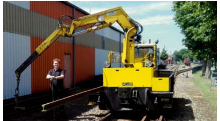
Einen Monat später: Am Bahnhof Bruchhausen-Vilsen muss der Vorrat an Ersatzschienen mittels Skl 1 „Friedhelm“ umsortiert werden. 25. Juni 2020, Foto: RA
