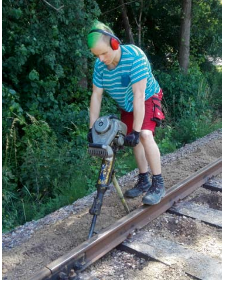
Max Hunold stopft derweil die fertig montierten Schienenstöße mit dem Benzin-Stopfhammer. Keine beliebte Arbeit, aber sie muss gemacht werden! Asendorf, 27. Juni 2020. Foto: RA
