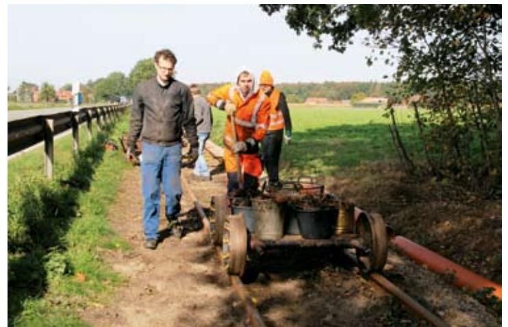
Das alte Kleineisen wurde nach dem Ausbau gesammelt und auf Wiederverwendung geprüft: Richard Wilkening, Bernhard Öhler, Lukas Schwarzer und Christian Fuhrmann-Kempe bei der Arbeit.
