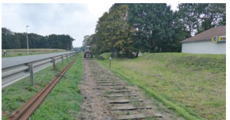
Ein Stück weiter sind die Schienen schon beiseite gerückt, und Ralf Hormann kann die Altschwellen mit der Radladergabel zügig einsammeln. 8. Oktober 2019. Foto: Robert Angerhausen
